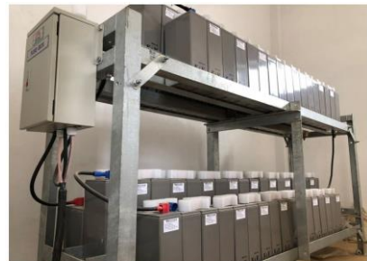
Giàn ắc quy 220VDC TBA 110kV Bùn Hồ - CPC
